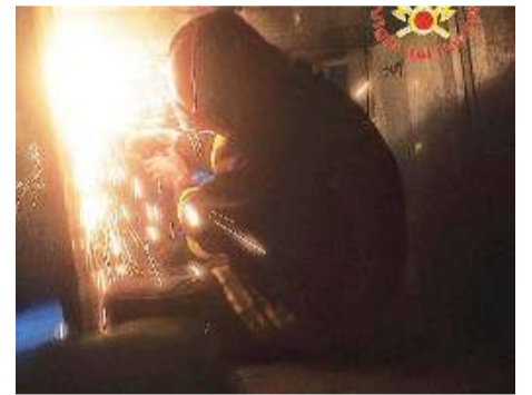
I soccorsi. Vigili del Fuoco durante l'intervento
